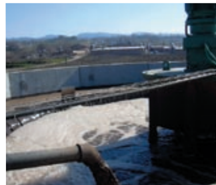
Vista superficial del reactor aerobi d'una instal·lació per a l'eliminació de nitrogen situada a Calldetenes (Osona). Foto: A. Magrí.
