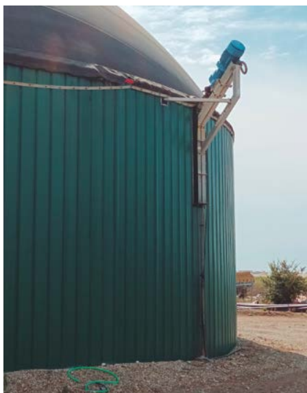
Planta de biogás. Foto: DACC.
