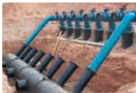
Cabezal de distribución en riego por aspersión. Foto: J.M. Tarjuelo.
