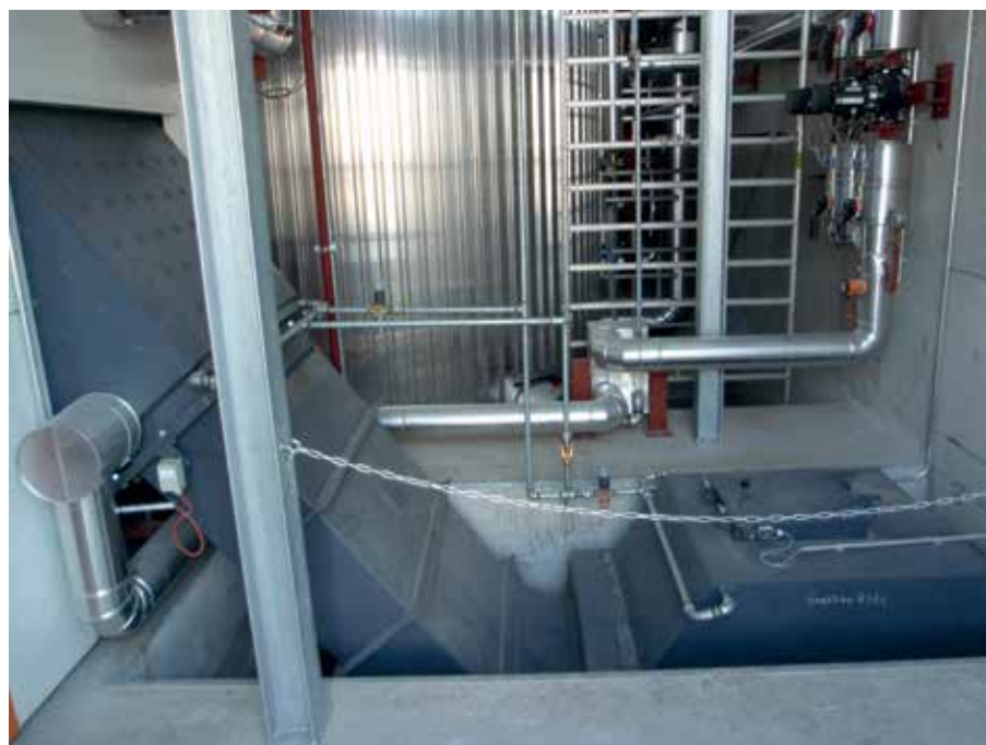
Foto 5. Alimentació amb pistó hidràulic per a una caldera de 3 MW en una petita central de cogeneració. Autor: AFIB-CTFC.
