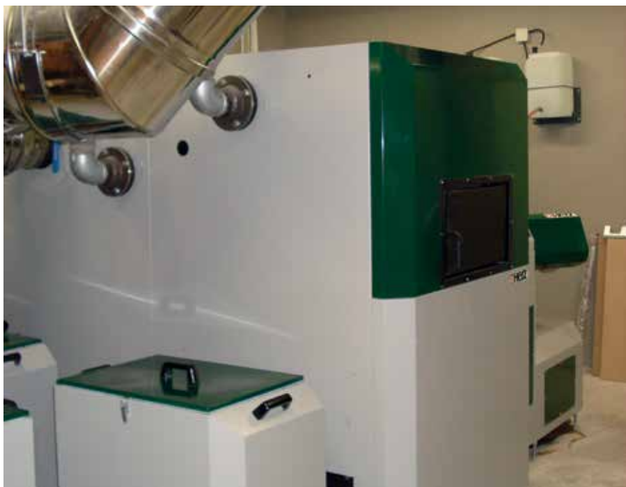
Foto 4. Caldera de 500 MW instal·lada en una piscina municipal. Autora: Francesca Famadas.
