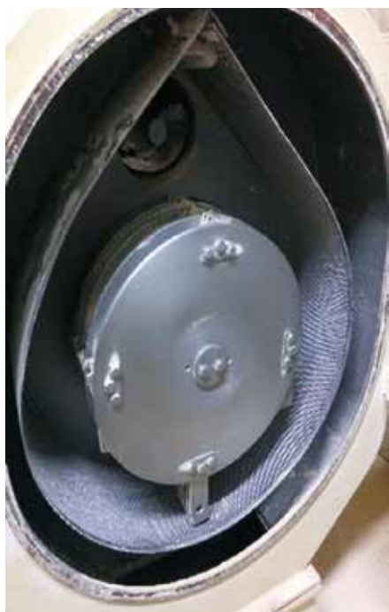
Figura 6. Granuladora oberta per a realitzar el manteniment. Autora: M. Carme Soler, ASFAC.
