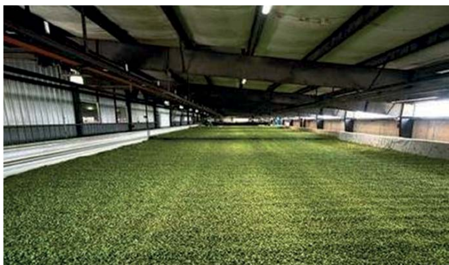
Instal·lacions industrials per l'assecat del llúpol. Foto: Hopsteiner
