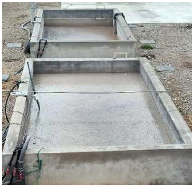
Foto 1: Dipòsits de recepció de purins. Autor: Gerardo Blanco
