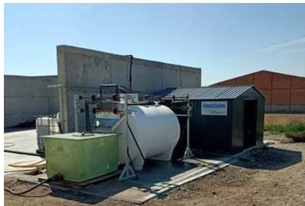
Foto 2: dipòsit de recollida d'escumes, dipòsit de tractament i caseta amb equips d'ozó, d'incorporació de coagulants i floculants i del circuit de filtració. Autor: Gerardo Blanco
