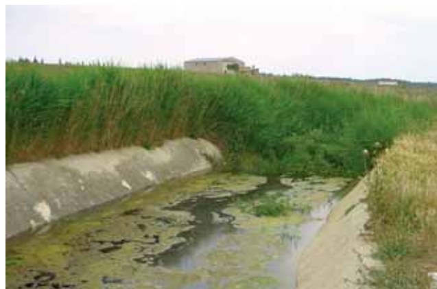
Canal de desguaces con características de eutrofización por la presencia excesiva de nutrientes como el N y el P, hecho que provoca falta de oxígeno en las aguas, en una zona regada del valle del Ebro. Foto: JM. Villar.
