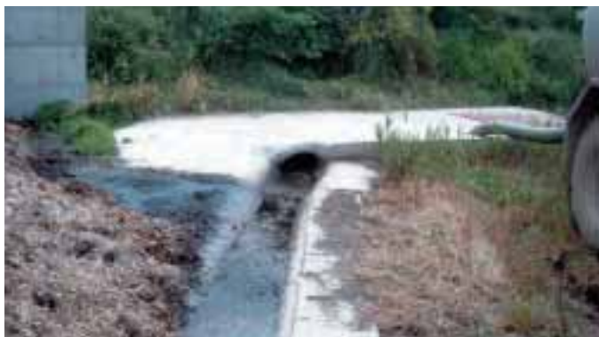
Foto 1. Sistema de recogida de fluidos del estercolero hacia un depósito para el líquido de escorrentía. M.R. Teira.
