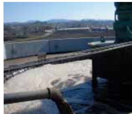
Vista superficial del reactor aerobio de una instalación para la eliminación de nitrógeno situada en Calldetenes (Osona). Foto: A. Magrí.
