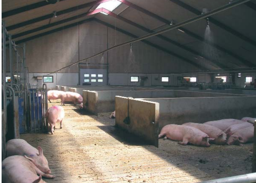
Sistema de refrigeración de nave.
