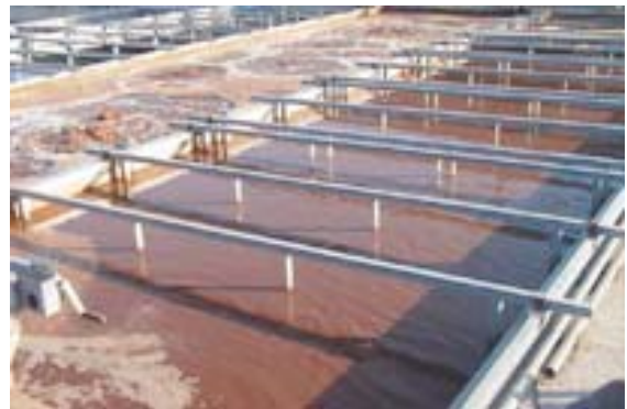
Figura 4.13. Detall reactor aerobi (esquerra) i reactor anòxic (dreta)
