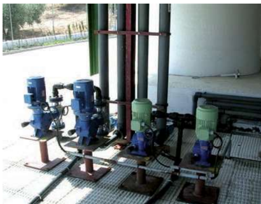
Instalación de fertirrigación: bombas dosificadoras eléctricas
