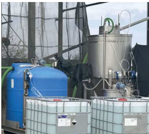
Planta pilot de tractament per a la precipitació d'estruvita a partir de digestat
