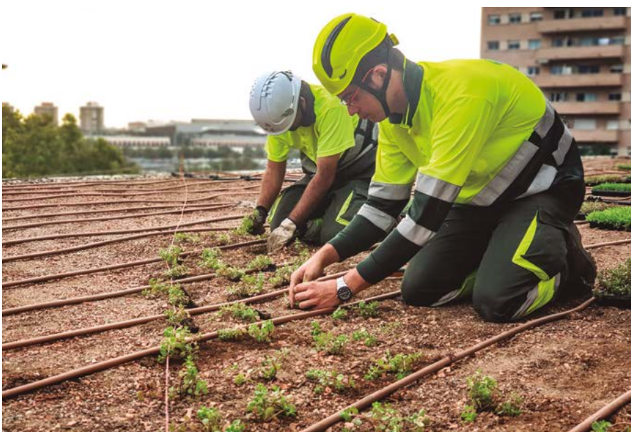
Treballadors de TEB Verd fent feines de plantació a la coberta de TEB Sant Andreu. Foto: Dpt. de Comunicació TEB.
