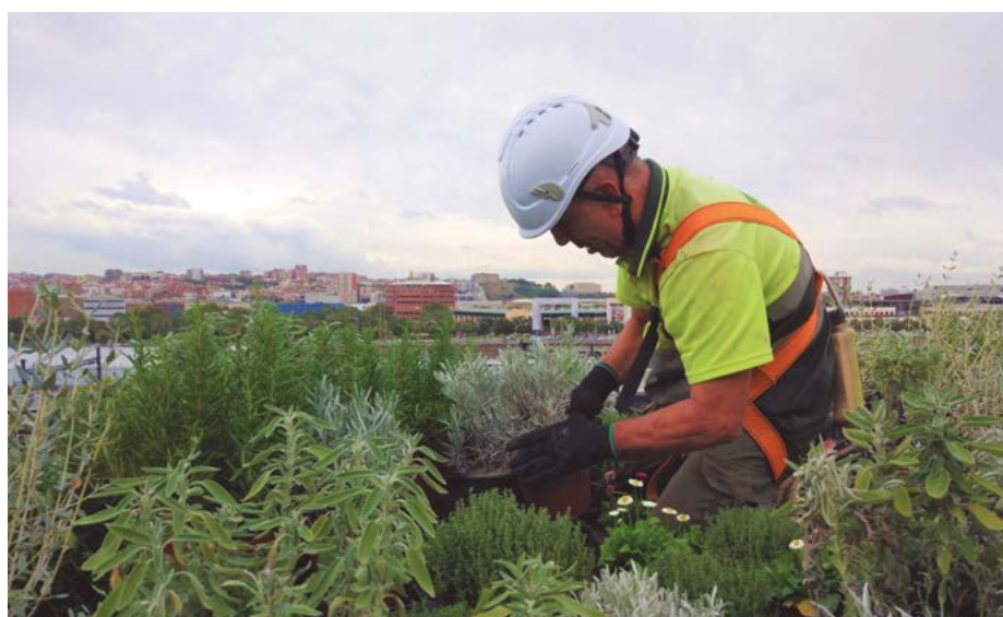
Jardiner de TEB Verd fent tasques de manteniment al terrat floral. Foto: Dpt. de Comunicació TEB.
