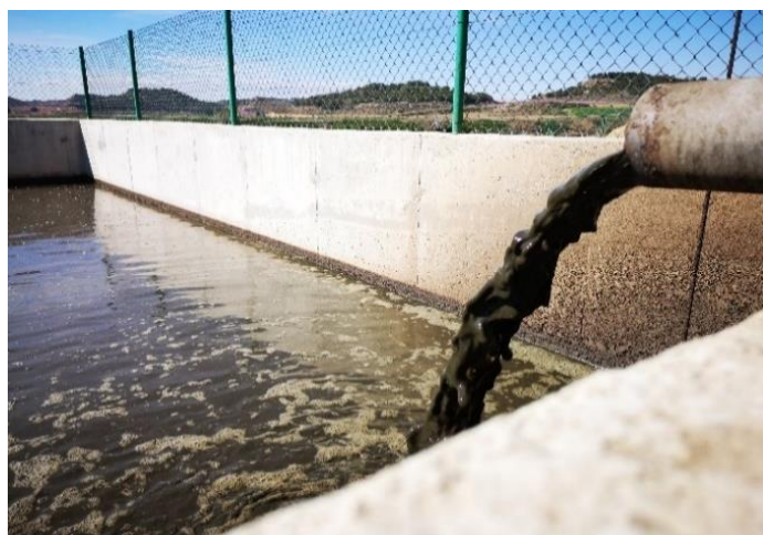
Foto 1: Bassa de recepció del digestat (Font: DARPA, 2019)
